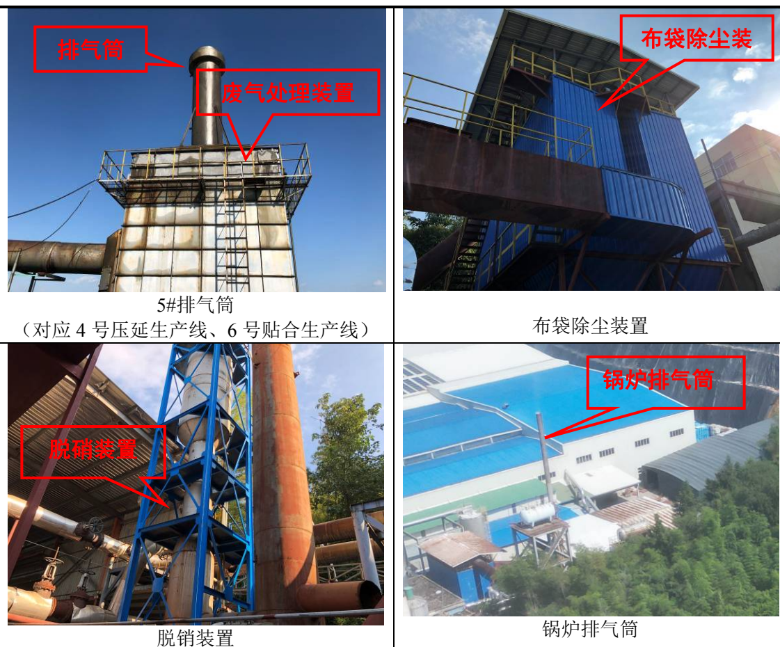
图 2.6-6 现有工程排气筒
