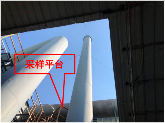
2#排气筒 （对应 1 号、2 号、3 号贴合生产线）
