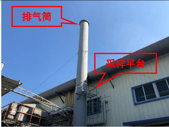
3#排气筒（对应 4 号贴合生产线）
